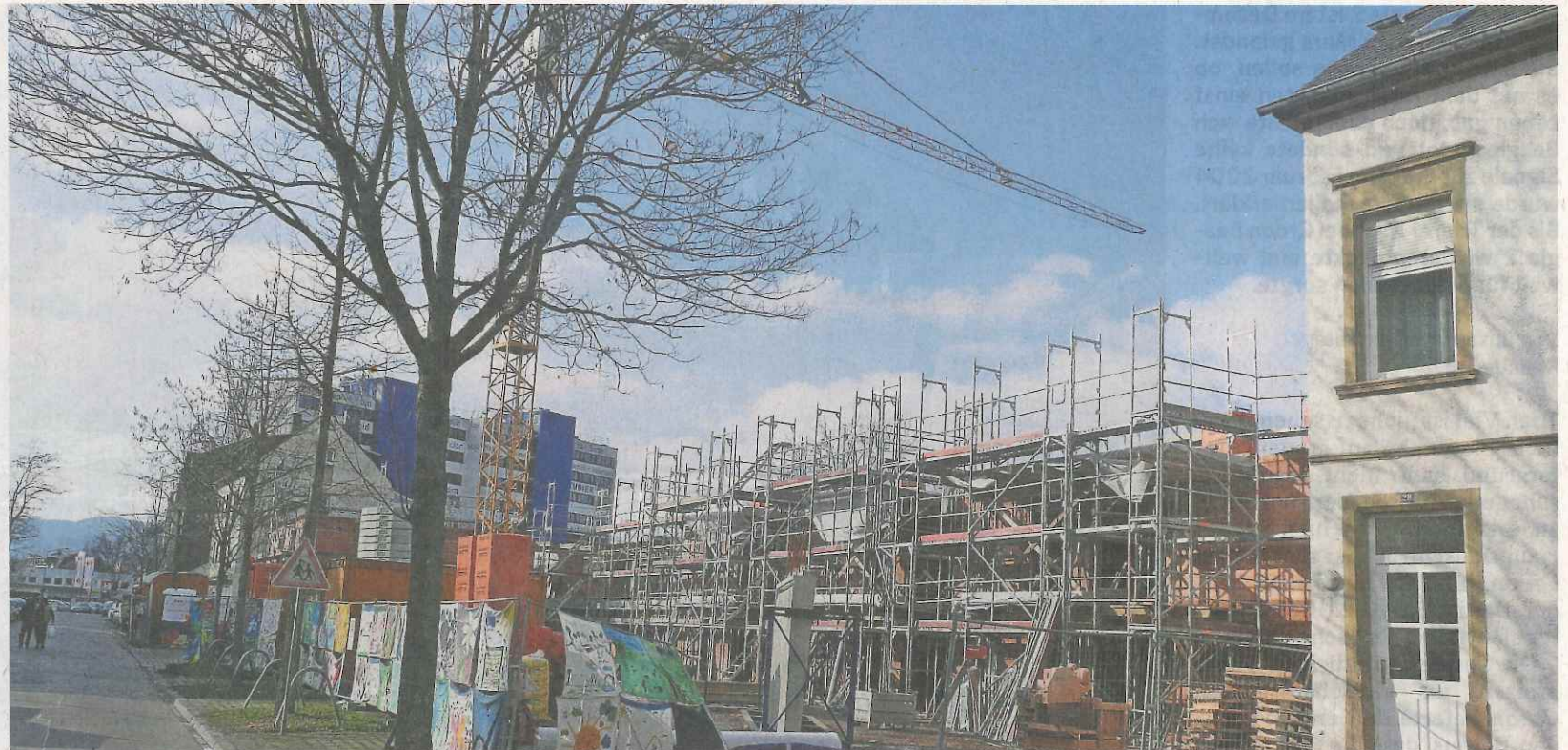
Die Bauarbeiten für das gemeinschaftliche Wohnprojekt der Wogebe in der Thyrsusstraße sind in vollem Gange, während dahinter beim Hochbunker noch eine große Lücke klafft. Die Projekte werden mit Hilfe des Programms Soziale Stadt realisiert. TV-FOTO: DOROTHEE QUARÉ
